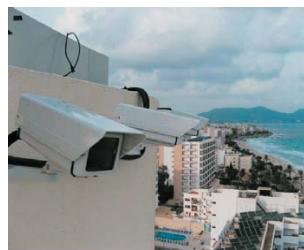
Vista del sistema remot instal·lat
