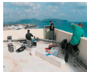
Instal·lació del sistema d'adquisició de dades
