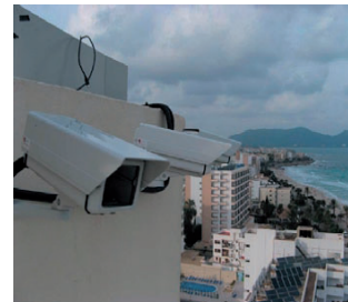
Vista del sistema remot instal·lat
