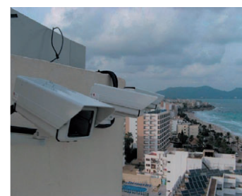
Vista del sistema remoto instalado
